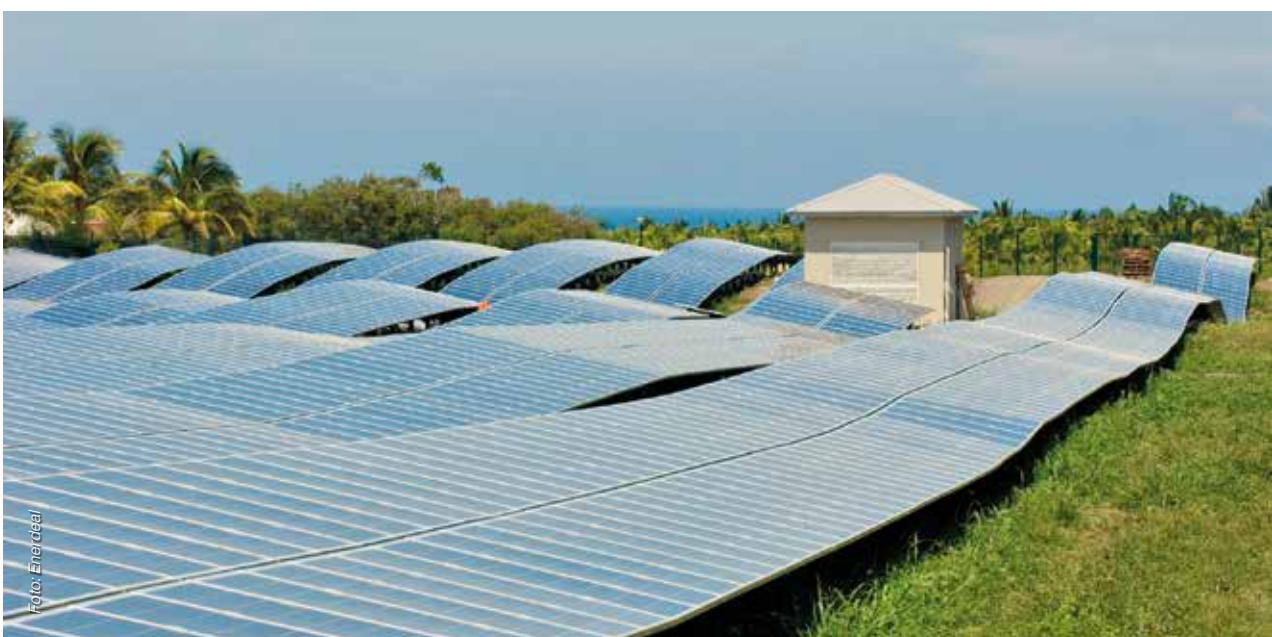
Het project in Manono betreft de installatie van een zonnecentrale van 1 MWp op de vaste grond, gekoppeld aan een batterijsysteem van 3 MWh.
