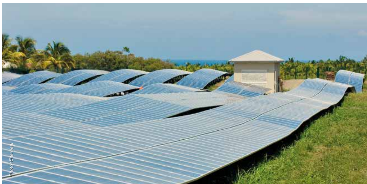
Le projet de Manono porte sur l'installation d'un vaste parc solaire au sol d'une puissance d'1 MWC, couplée à un système à accumulateurs de 3 MWh.
